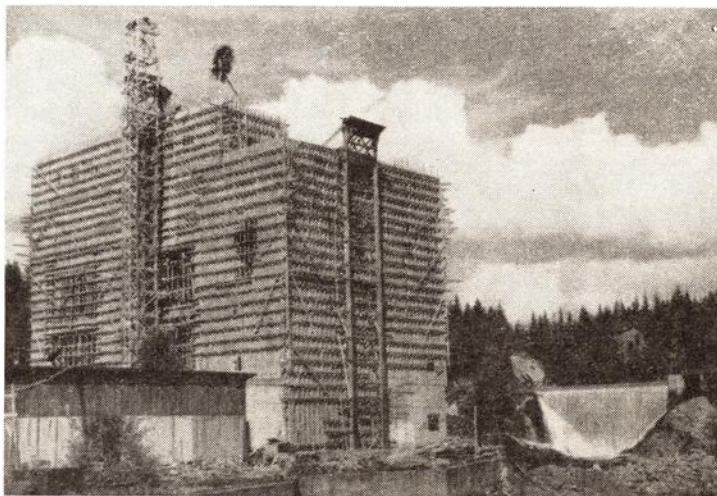
Fyrhuset etter at kranen var heist i august i fjor. Når huset er helt ferdig og tomten ryddet, skal vi komme tilbake med et nytt bilde og nærmere detaljer om bygningen.
